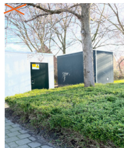
▲ Niet: losse trafo's in de openbare ruimte.
