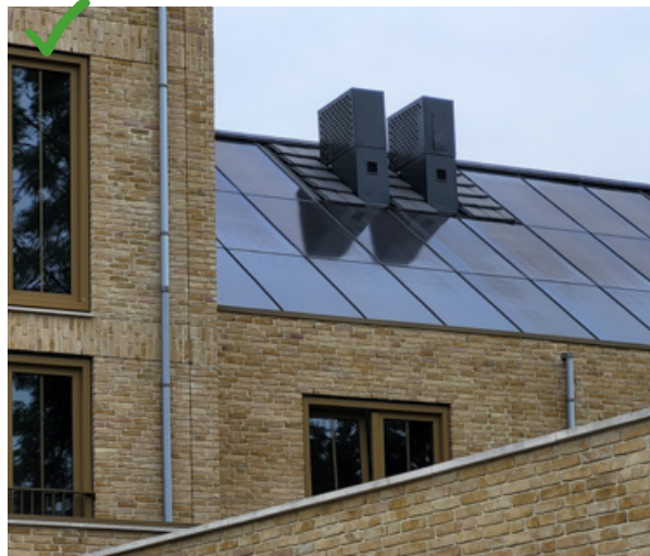
▲ Wel: afvoeren geclusterd in een dakdoorvoer
