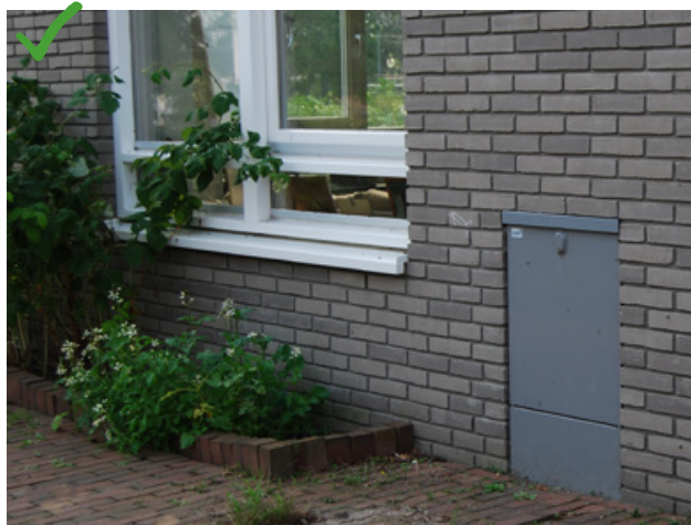
▲ Wel: cai-kasten geïntegreerd in gebouw
